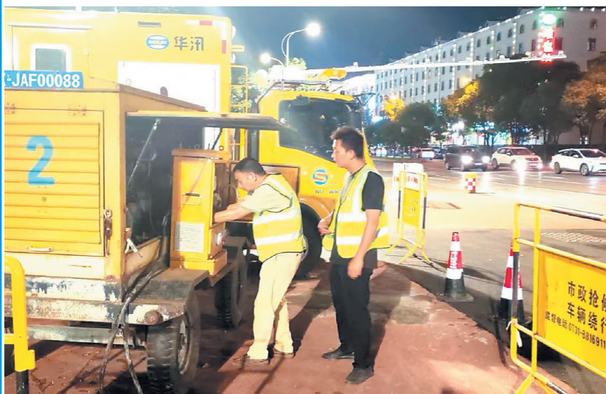
市政部门实施力量前置布防，排涝车辆及作业人员已全部在岗待命。均为市城管局供图
